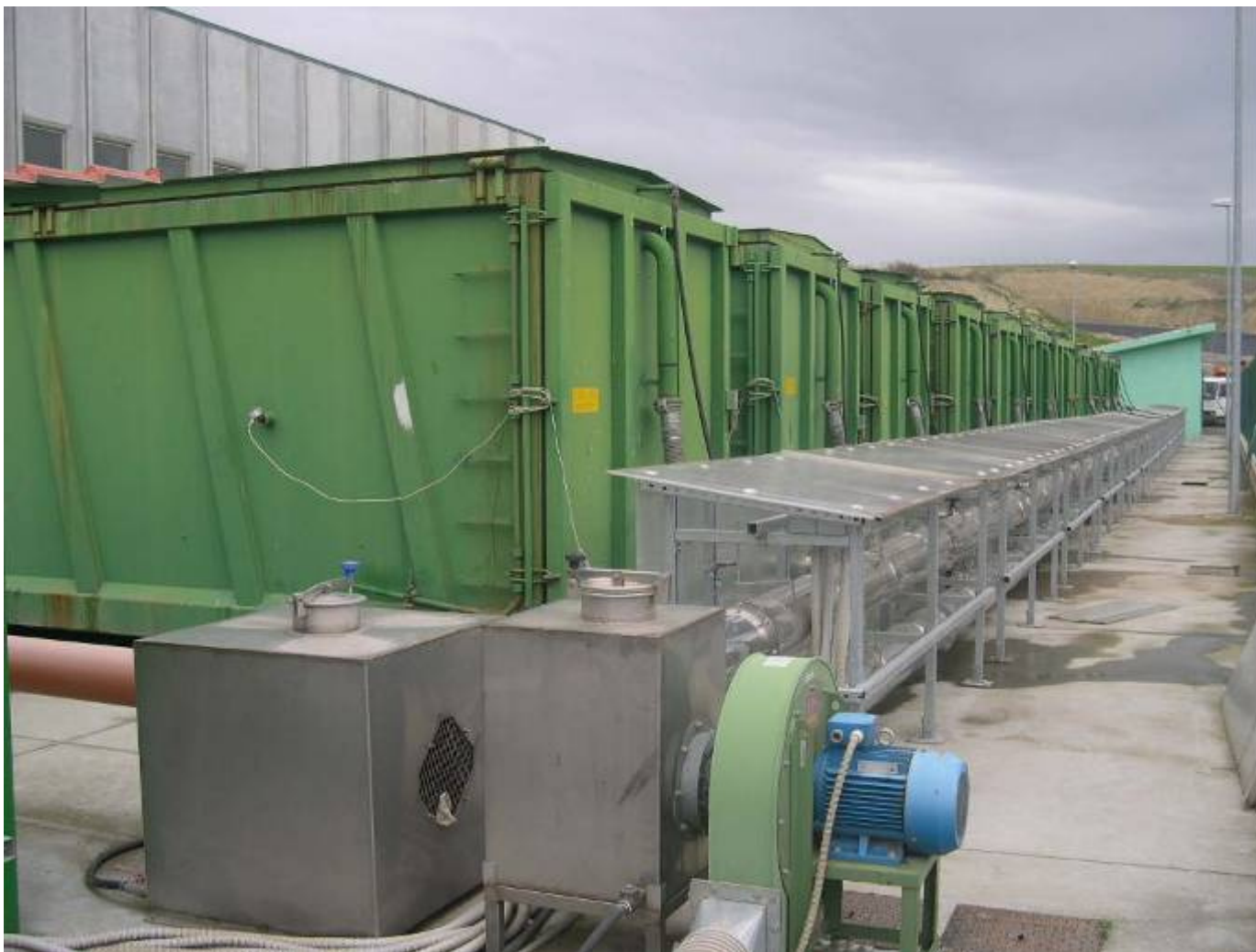
Particolare del sistema di insufflaggio aria alle biocelle
